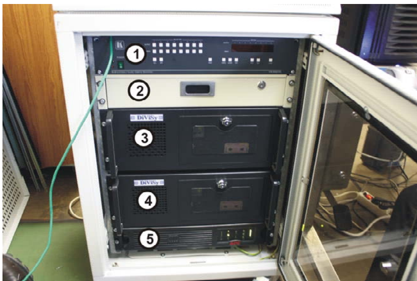
Шкаф (вид спереди)
